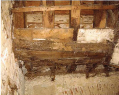
Fig. 2 - Deformação da estrutura de suporte da escada
